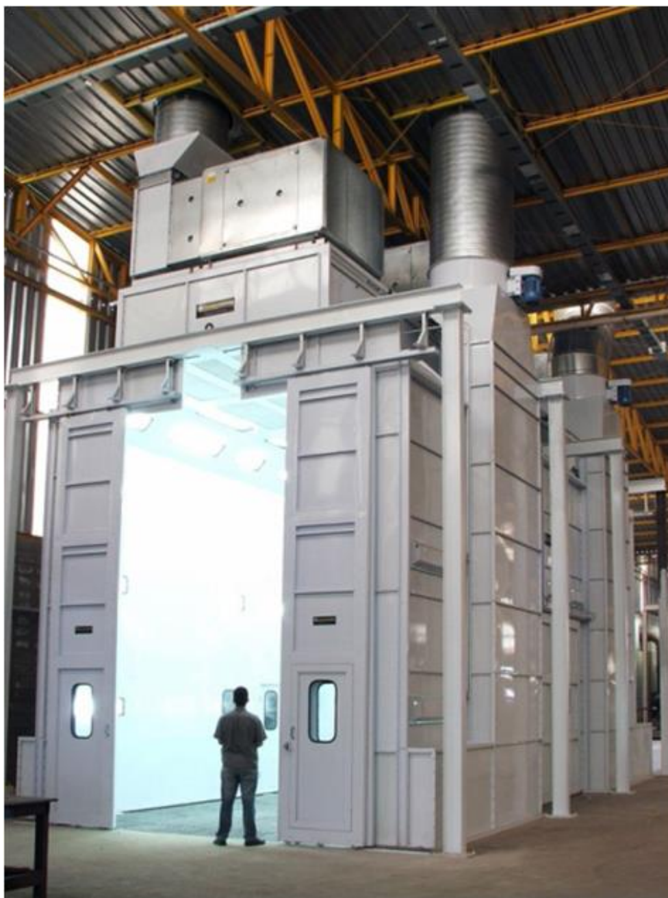
Figura 22: Cabine de Pintura Liquida Fonte: Pedertractor S/A.
