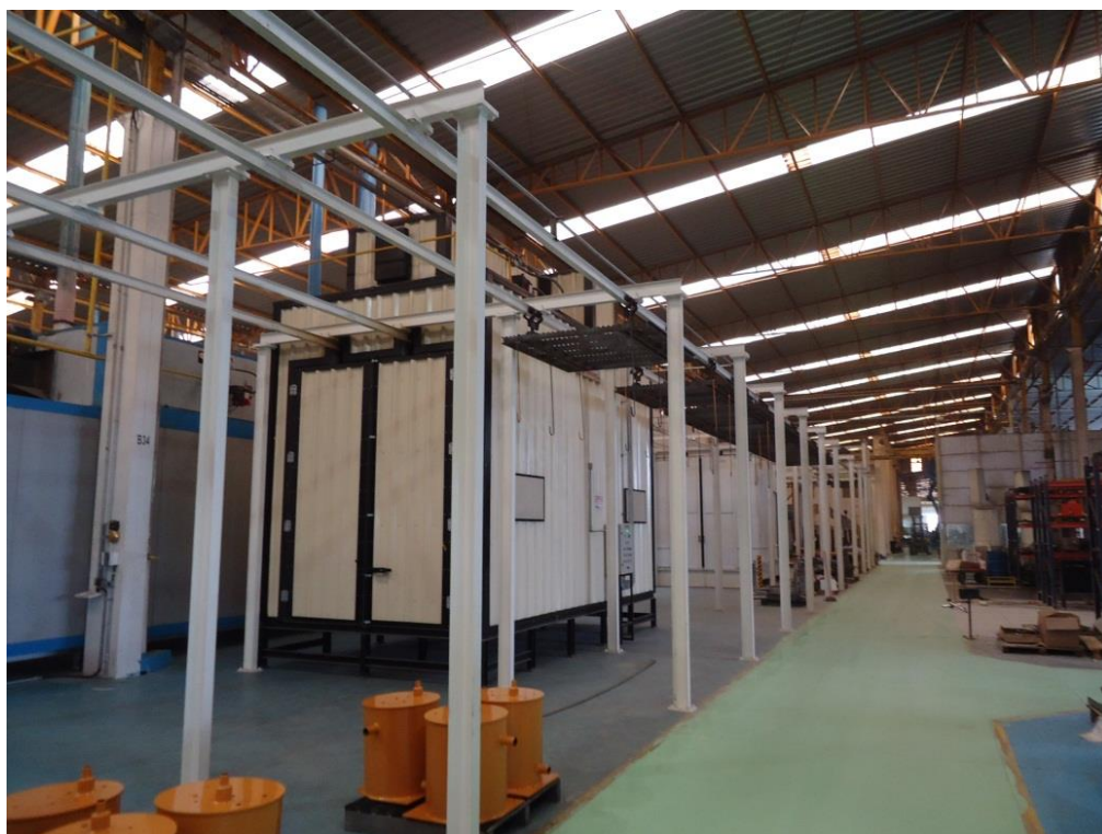
Figura 21: Cabine de Pintura a Pó Fonte: Pedertractor S/A.
